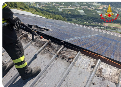
Tirano (SO), 28 luglio 2024: i pannelli bruciati sul tetto di una casa. Foto Vigili del Fuoco, Comando di Sondrio, CC BY 4.0.
